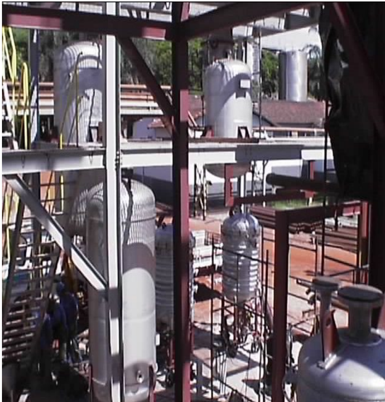
COLETA DOS PRODUTOS DA DESTILAÇÃO: MOSTO HIDROLIZADO, ETANOL RECUPERADO, LIGNINA
