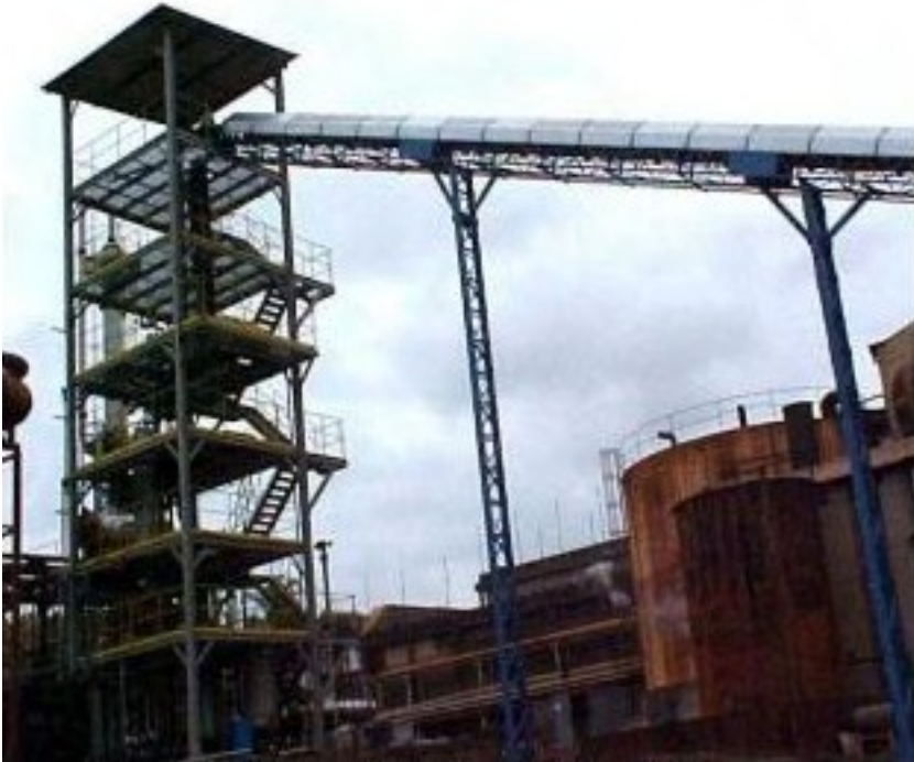
ESTRUTURA DO REATOR E SISTEMA DE ALIMENTAÇÃO DO BAGAÇO
