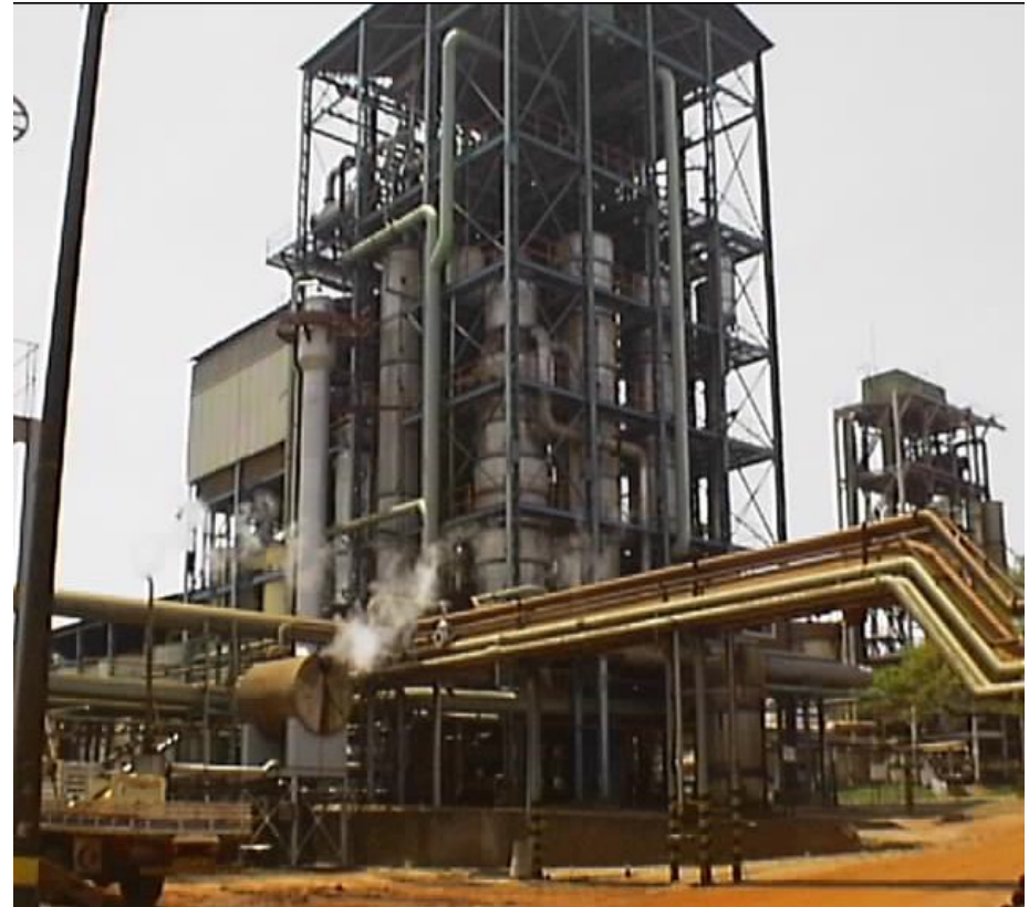
FERMENTAÇÃO E DESTILAÇÃO: UTILIZADAS AS INSTALAÇÕES EXISTENTES NA USINA
